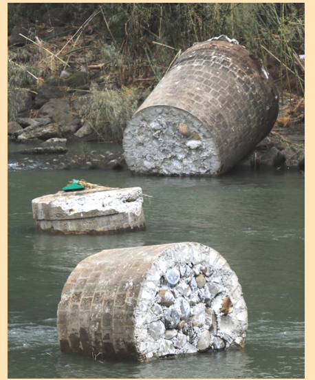
崩落した水郡線第6久慈川橋梁
